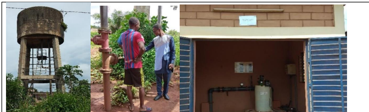
Visite du château d'eau fonctionnel avec sa station de chloration automatique, à Ikpinlè (commune d'Adja-Ouèrè)
